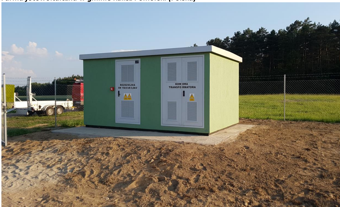
Rysunek 11 Budynek techniczny widziany od strony wejść do rozdzielni i komory transformatora
