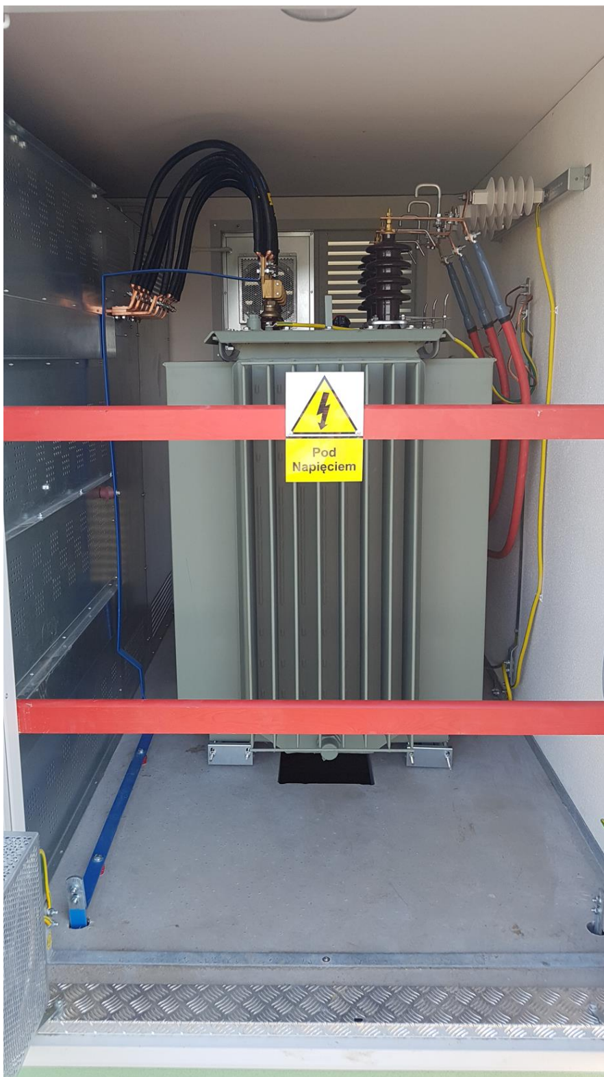
Rysunek 10 Wnętrze stacji transformatorowej o mocy 0,8 MVA
