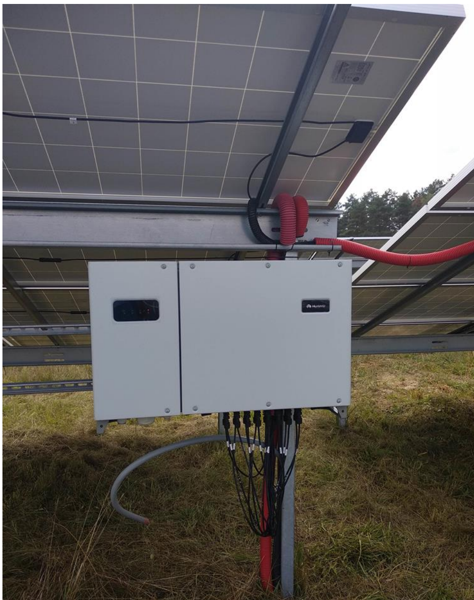
Rysunek 9 Widoczny inwerter zamocowany na konstrukcji nośnej paneli fotowoltaicznych
